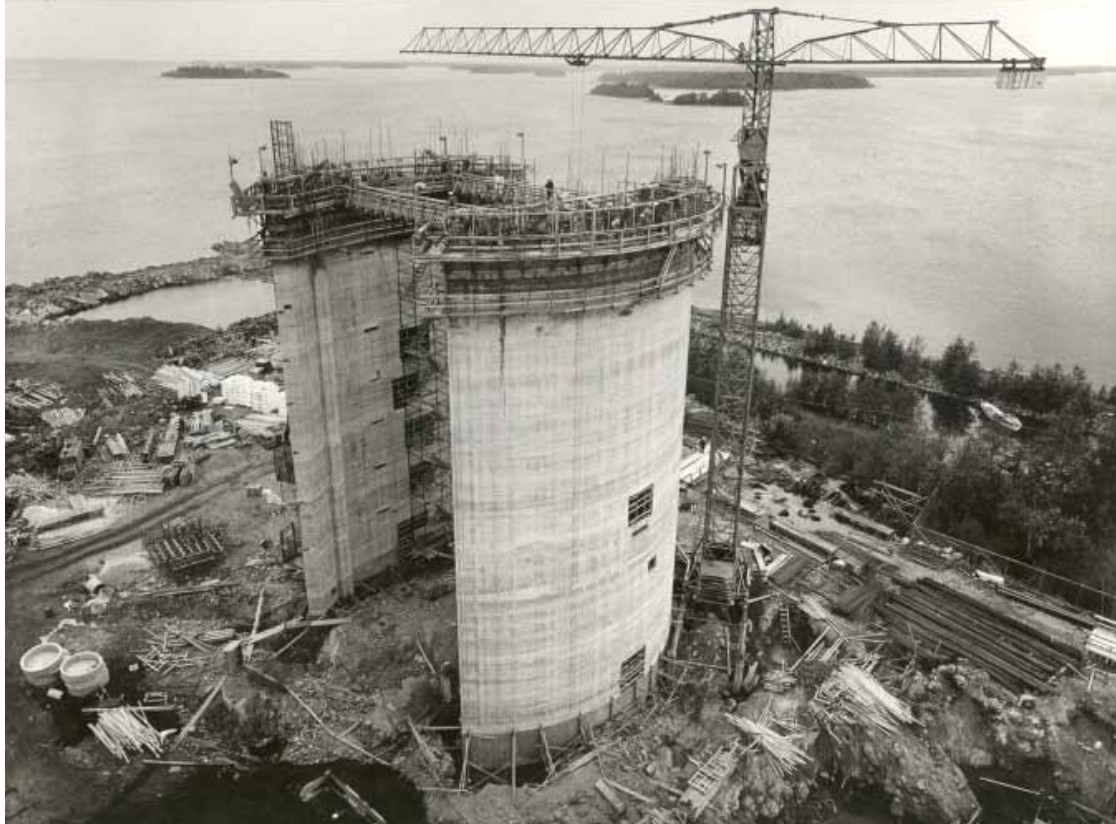
Nykyisin Vaskiluoto 3 -nimellä tunnettu voimalaitos 28.8.1969.
